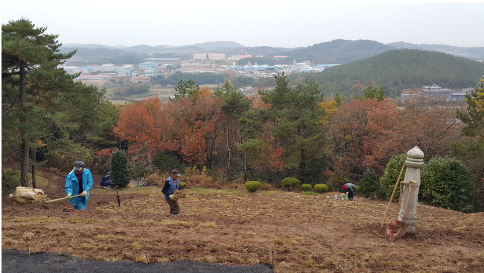
〈사진 7-41〉 묘 위 고랑을 생석회와 흙 배합토로 메우고 잔디를 다시 심어서, 묘에 물이 들어가지 않게 하여, 입력 지기에너지를 정상화.
